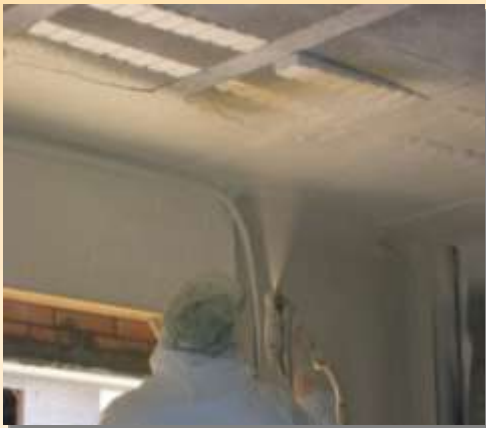
El poliuretano proyectado en el techo puede compensar pequeños desperfectos en las bovedillas
