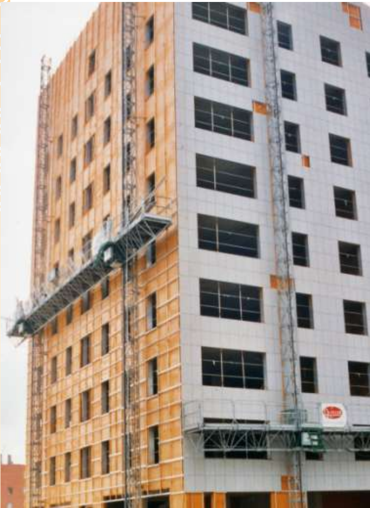
Fachada ventilada proyectada con espuma de poliuretano.
