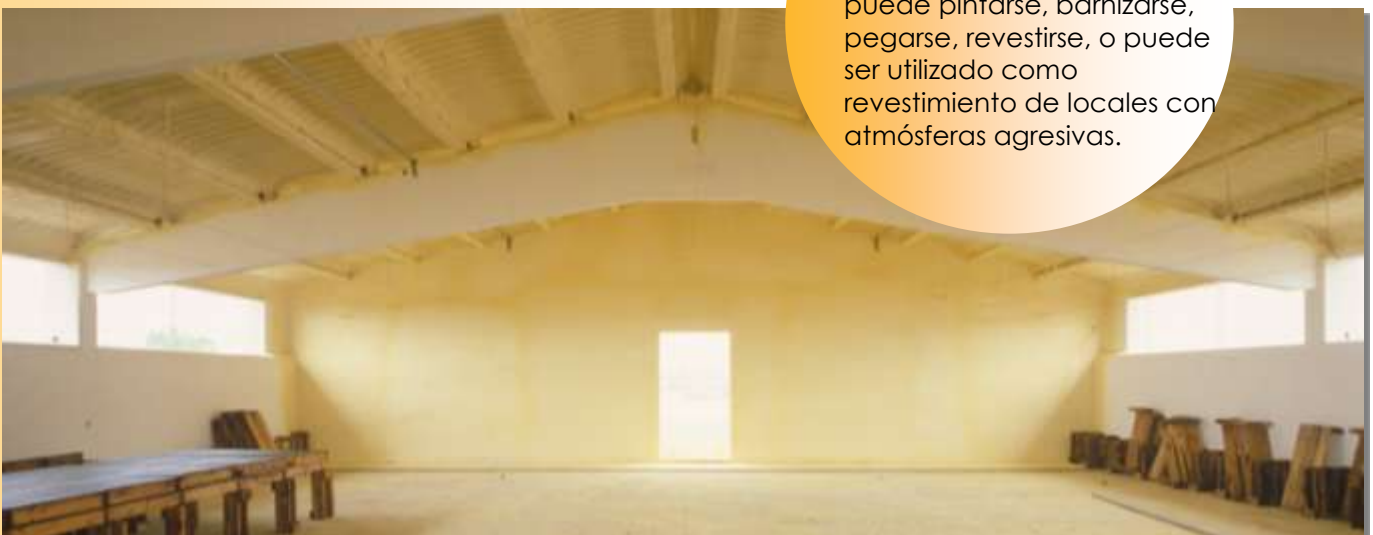
El poliuretano proyectado es resistente a ambientes industriales agresivos.
