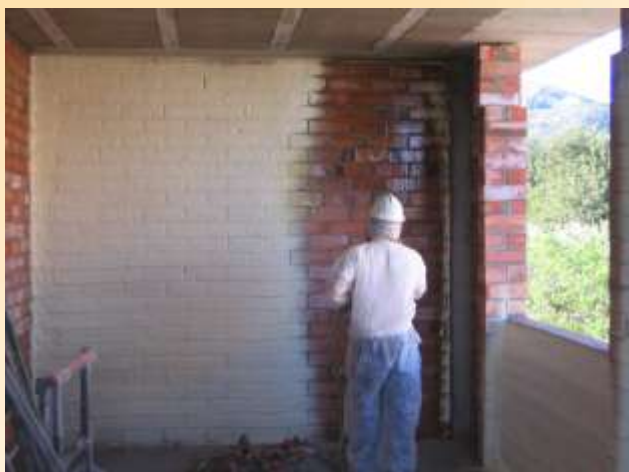
El grosor de poliuretano proyectado dependerá de la zona climática y de la composición del cerramiento
