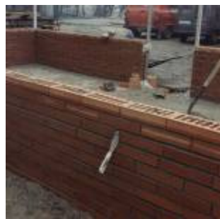
Detalle de las llagas verticales sin mortero.
